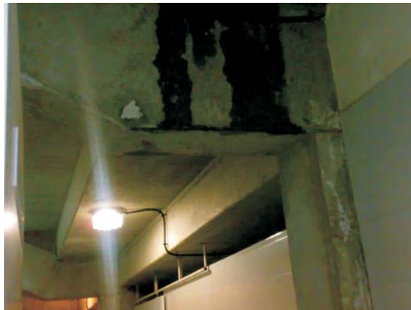
Humedades en techos
